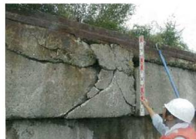
上部工割れ(43年経過)
