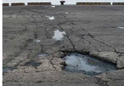
エプロンひび割れ、剥離(34年経過)
