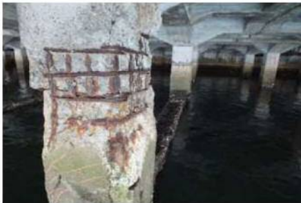
栈橋脚柱部鉄筋露出(48年経過)
